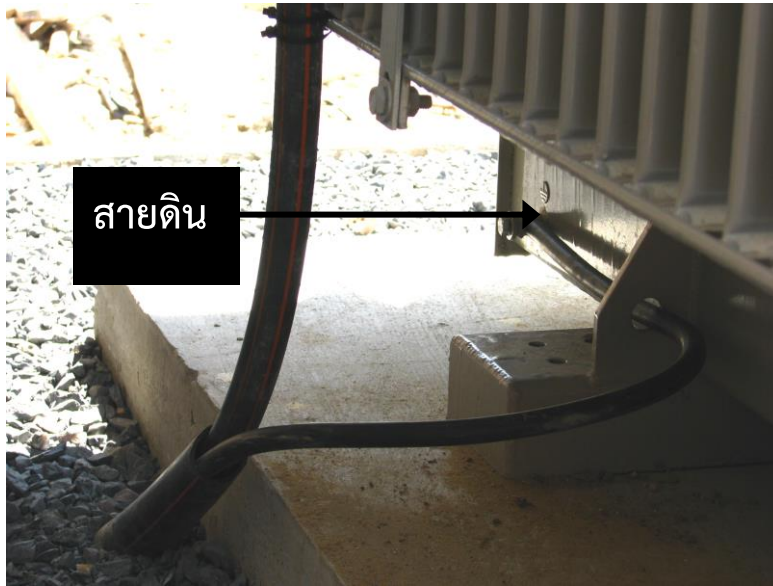
ภาพที่ 3.5 สายดินที่ตัวถังหม้อแปลง
