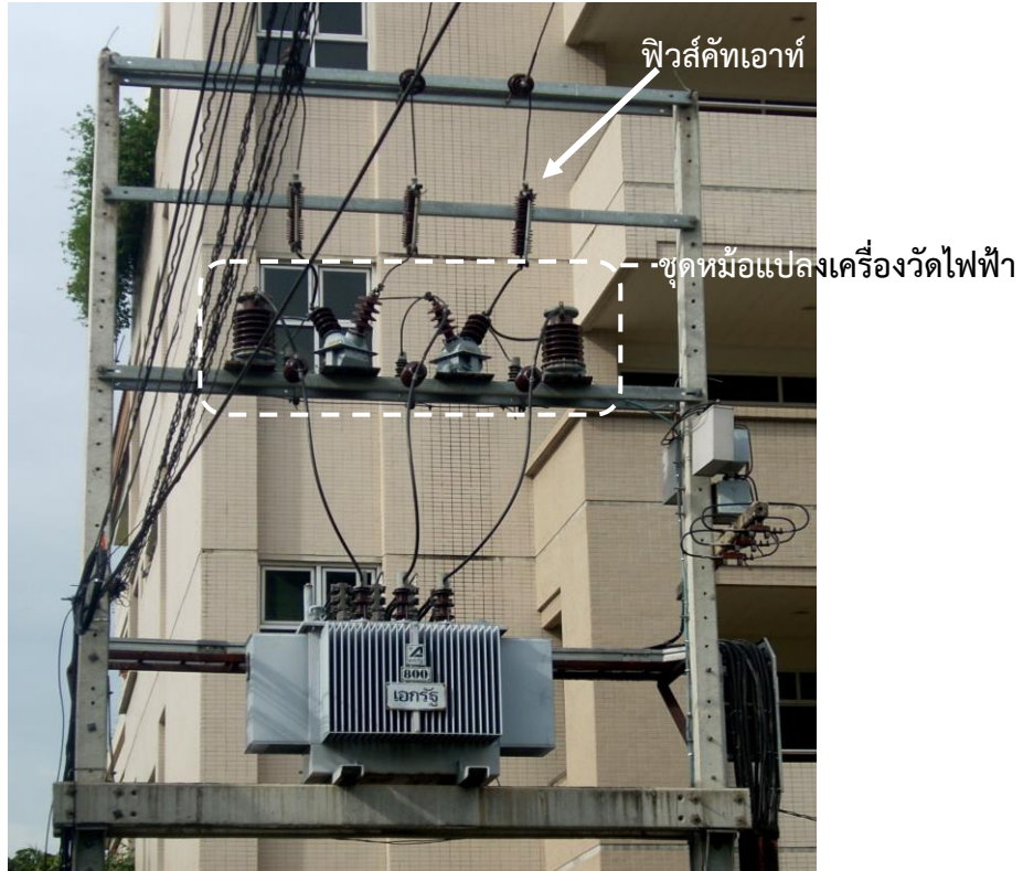
ภาพที่ 3.1 หม้อแปลงไฟฟ้าในระบบจำหน่ายและหม้อแปลงเครื่องวัด
